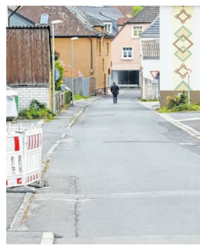
Eine zu dünne und verschlissene Asphalttschicht sowie zu schmale Gehsteige machen eine Sanierung der Neugasse notwendig. Foto: Günter Roth
