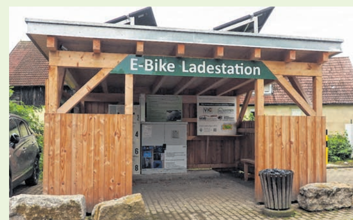
Die E-Bike Ladestation ist ein Projekt, welches mit Hilfe des Regionalbudgets der Allianz ILE MainWerrtal umgesetzt werden konnte. Das besondere der Anlage: Sie ist abgekoppelt vom regulären Stromnetz als autarke Inselanlage konzipiert. Foto: Tabea Goppelt
