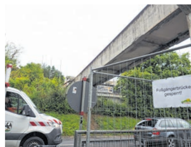
Die Fußgängerbrücke über der B 26a in Arnstein muss kurzfristig abgerissen werden. Für Fußgänger ist sie bereits gesperrt. Foto: Tabea Goppelt
